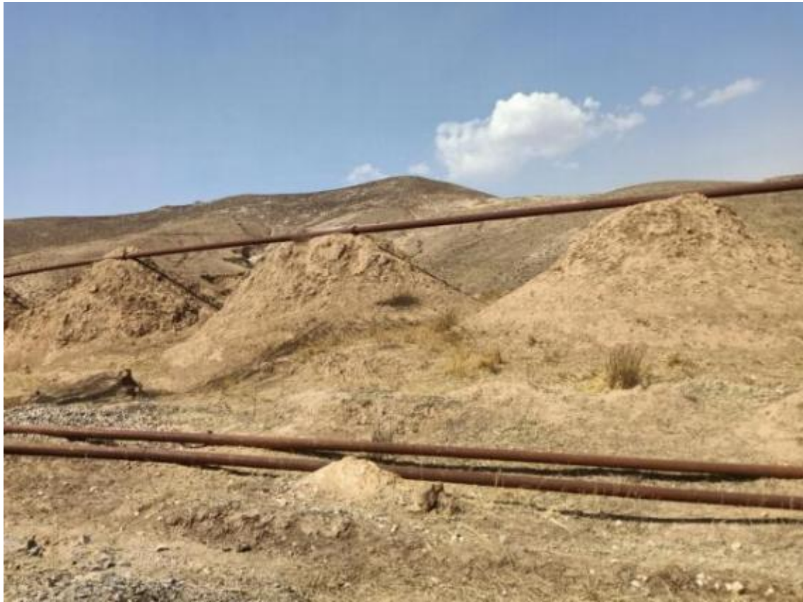
照片4-12 尾矿管路
